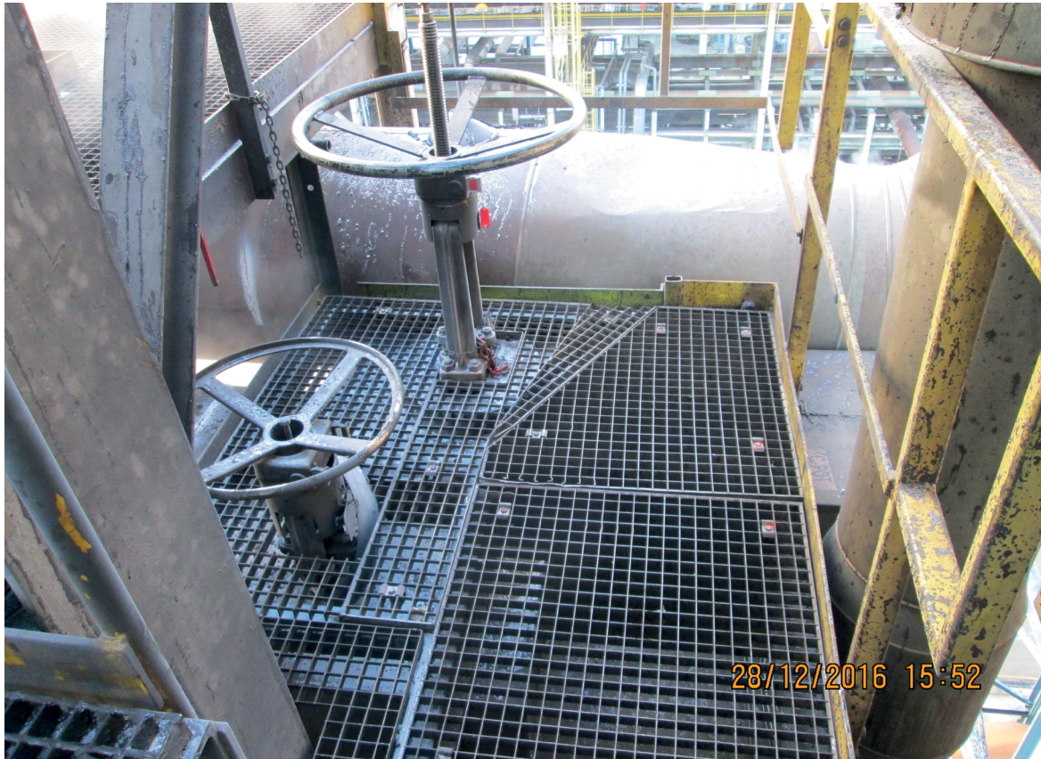
Figuur 8: Foto van bordes met buitenlucht- en cokespot-afsluiters (Bron: Inspectie SZW)
