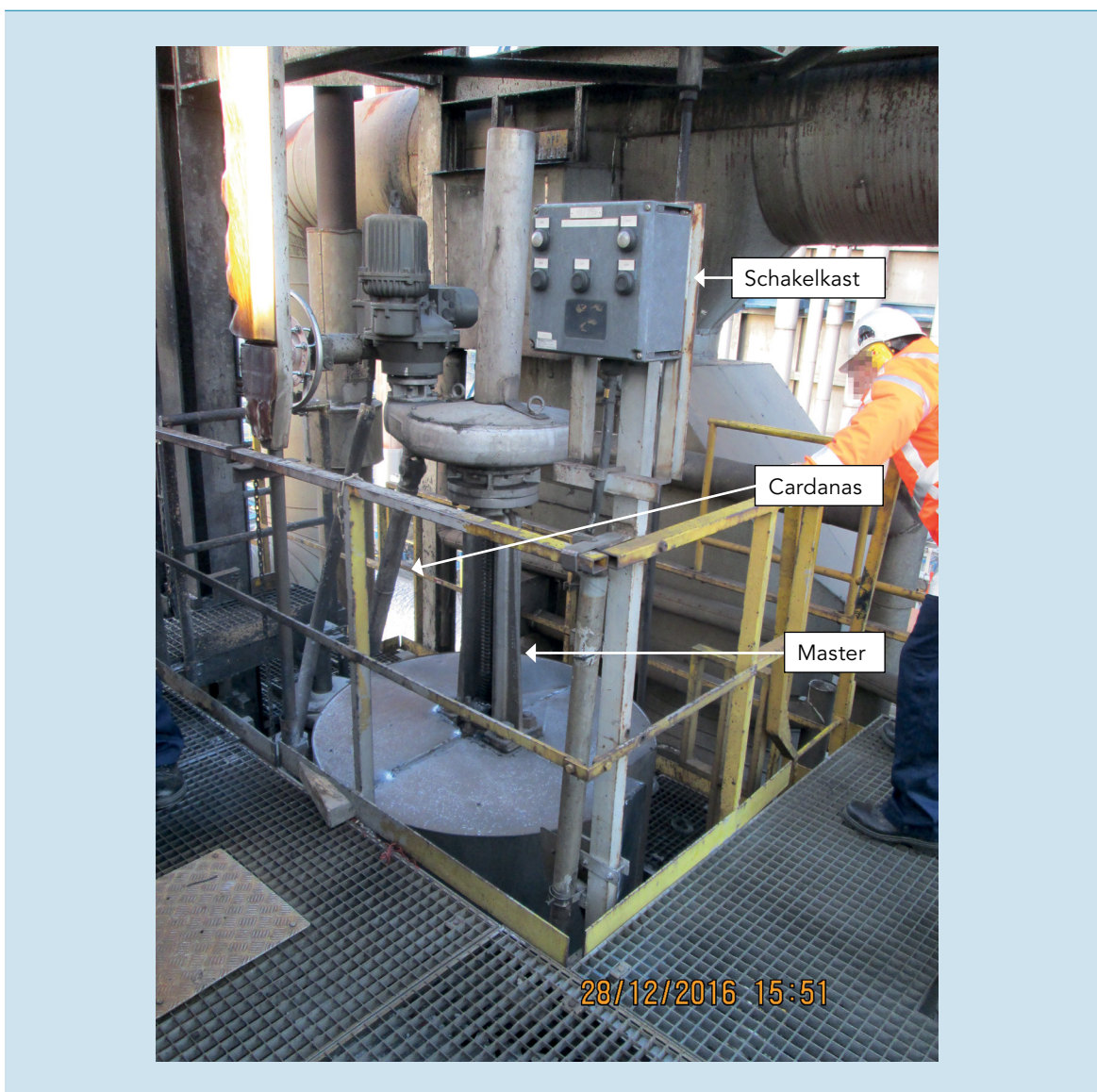
Figuur 11: Masterafsluiter met bedieningspaneel (Bron: Inspectie SZW)
